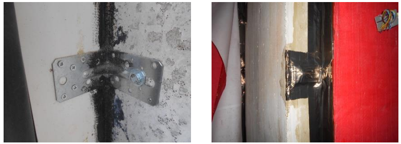
Afbeelding 5: afwerking verankering bij luchtdichting. Links is onjuist uitgevoerd, recht is correct uitgevoerd
